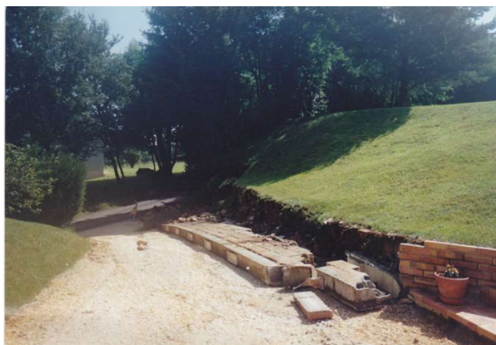
Effondrement d'un mur par suite d'une crue torrentielle (juin 2003)
